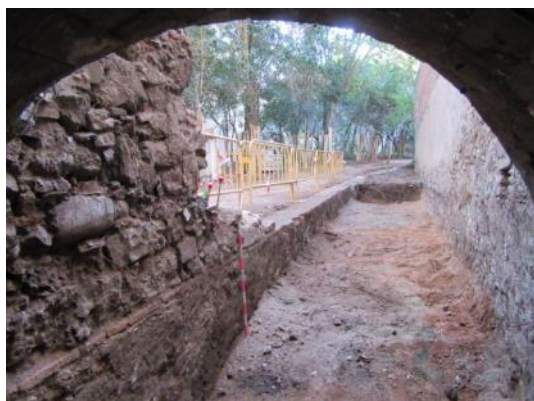
Foto 27. Vista del mur UE 7 des de l'interior del col·lector del carrer Peris i Mencheta. Vista des del nord-oest.
