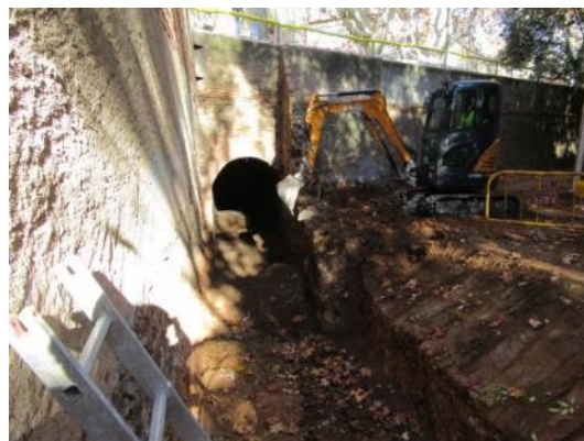
Foto 30. Desmuntatge parcial del tram inicial del mur UE 7. Vista des del sud.
